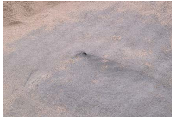
Bild 13: geortete Beschädigung, 15mm x 10mm
