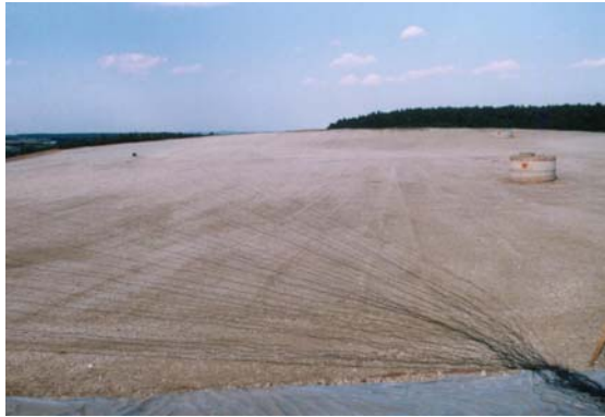
Bild 6: Die Kabel verlaufen strahlenförmig.
