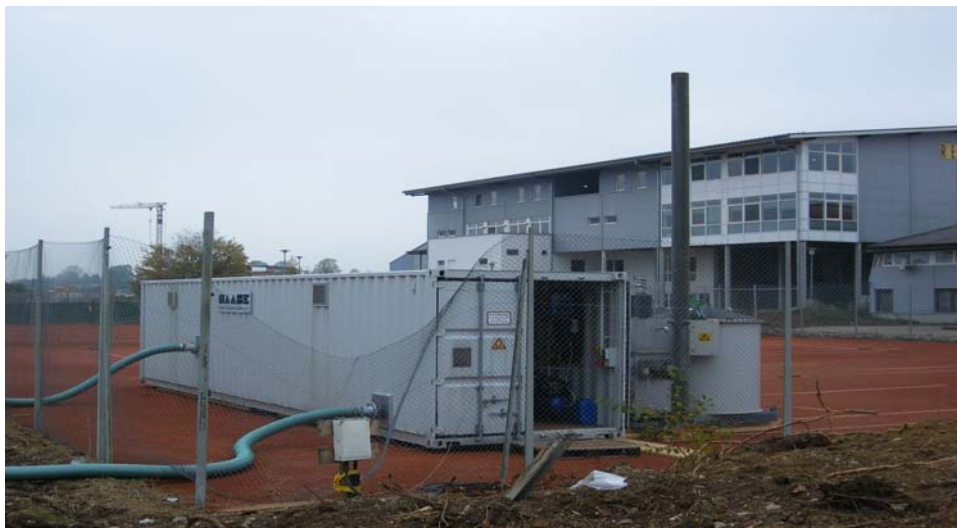
Abb. 4 Verdichter- und Schaltanlage (RTO)
