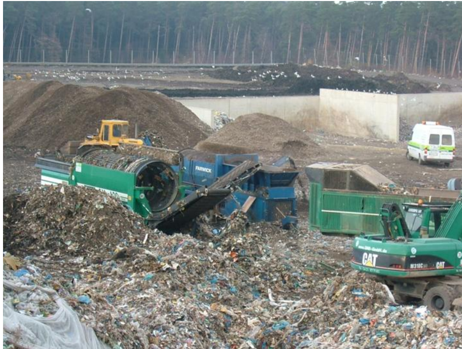
Bild 3: zeigt ein Beispiel für einen Einsatz eines Baggers, Radladers, Vorzerkleinerers und zweier Trommelsiebe
