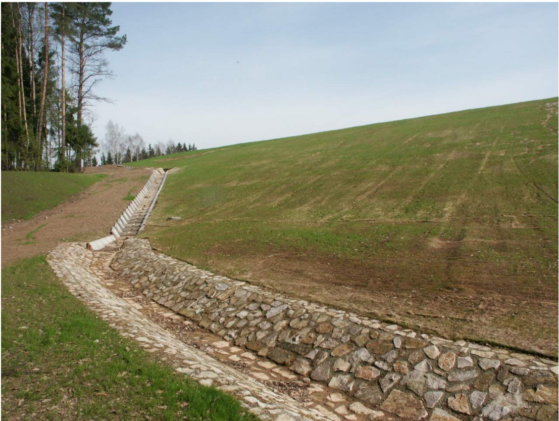
Abbildung 4.6: IAA Lengenfeld – Zustand nach einem Monat
