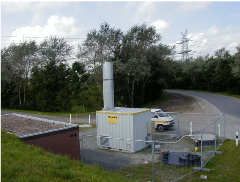
Abbildung 5: Deponiegasverdichter- und Fackelanlage (750 kW th )
