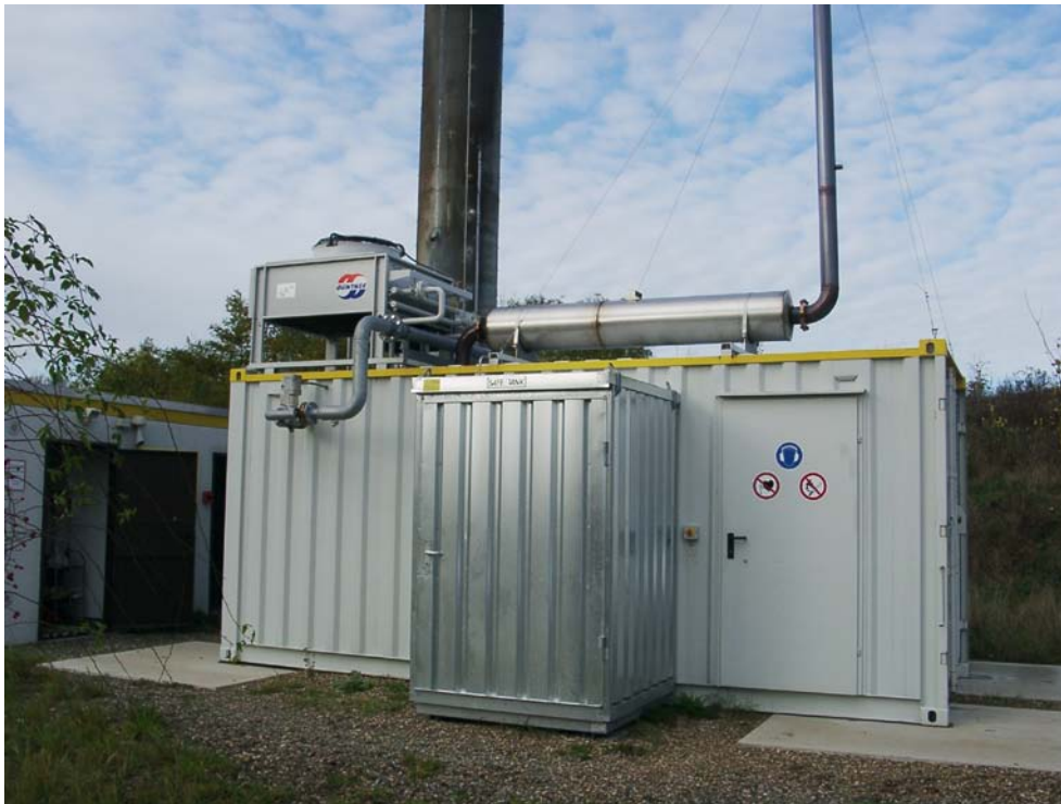
Abbildung 7: Deponiegas-BHKW mit Gasverdichter (Kompaktanlage 143 kW eI )
