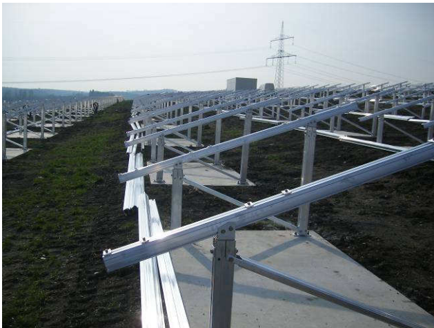
Abb. 3: Modultisch auf Betonplatte
